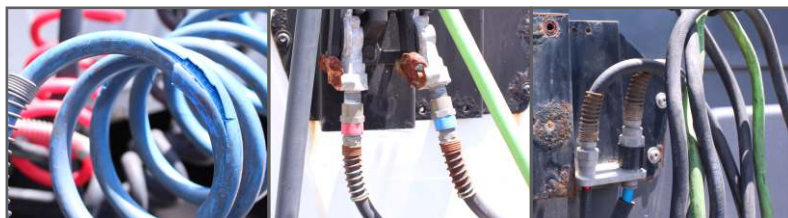
Encamisados dañados o resortes oxidados
